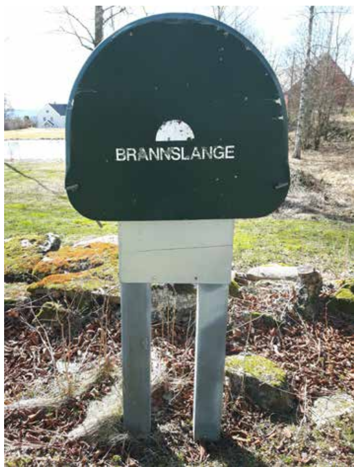
Nåværende brannsikring av Drammens eldste bygning.
